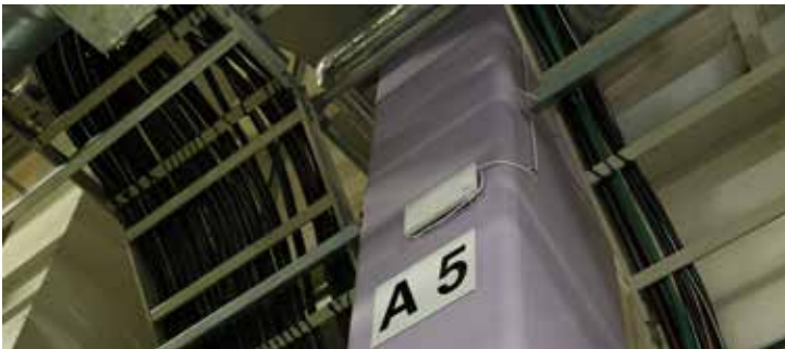
屋内型 AP MR33 が工場内にくまなく設置
