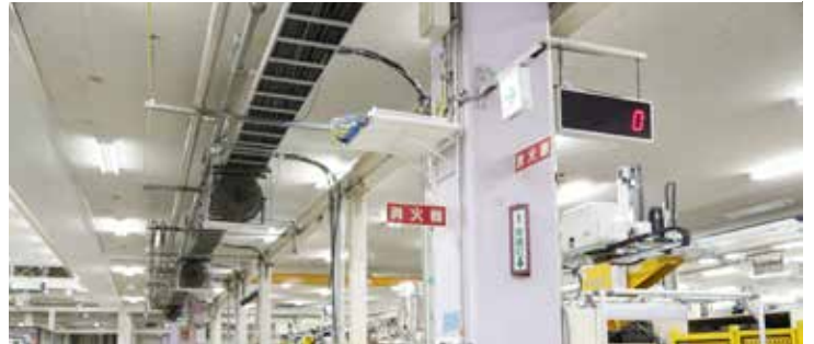
AP や有線 LAN をつなぐ 拠 点 として MS225 などのスイッチが工場内の 各所に設置
